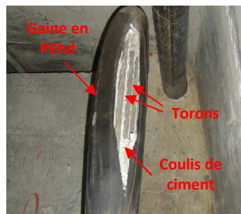
Figure VI-15 : Exemple de fissure longitudinale de gaines de précontrainte extérieure [195]
