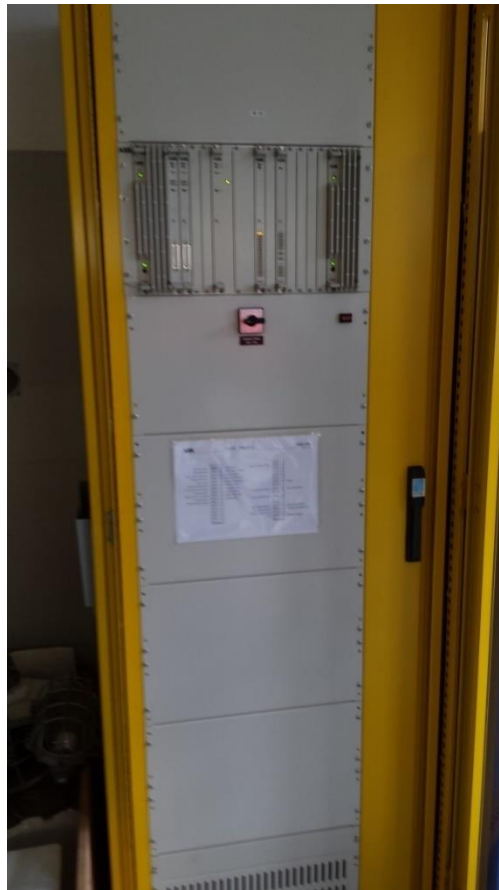
Figure 15 : Armoire de protection d'un groupe à turbine Francis
