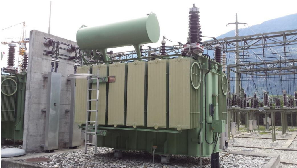
Figure 12 : Transformateur triphasé de 25MVA, 8/65 kV du poste de couplage de St-léonard
