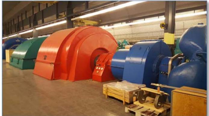
Figure 15 : Photo d'un groupe ternaire de Veytaux : vert-turbine, rouge-moteur, bleu-pompe
