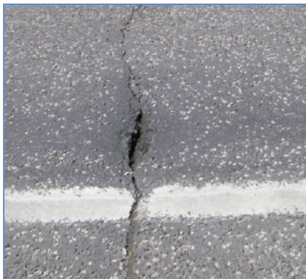
Figure 1.9 Dégradation par fissuration Tirée de Eula (2011)
