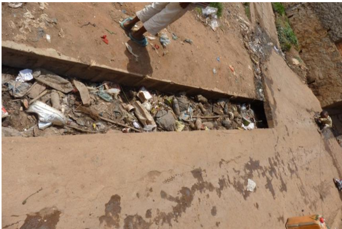
Photo n°10: Le rejet des ordures dans les canaux d'évacuation à Manjakaray II-C.
