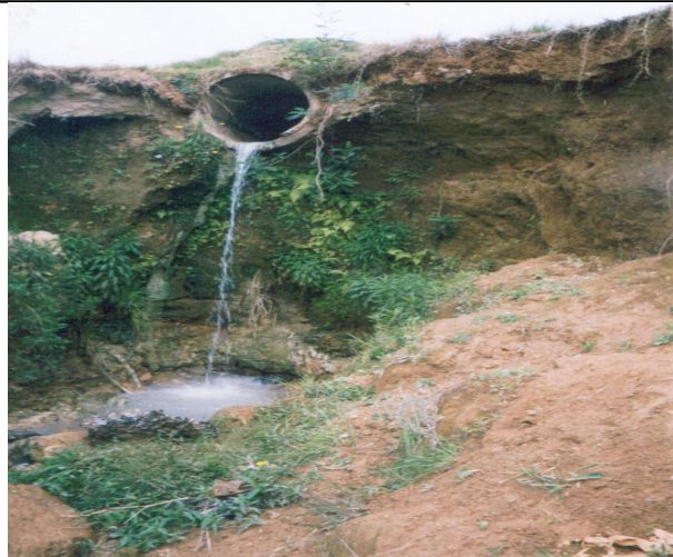
PHOTO V : Buse d'évacuation des eaux usées de U1
