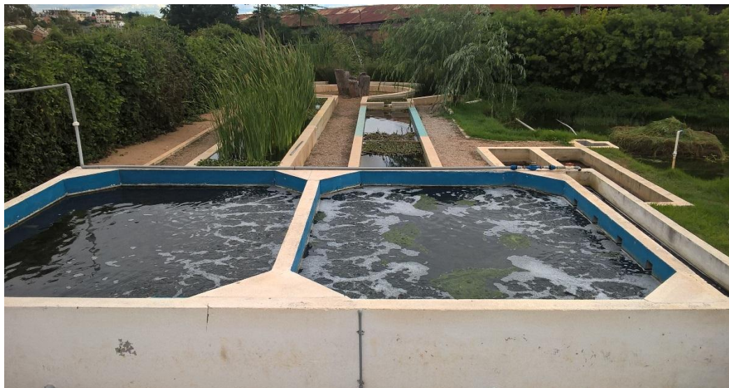
Figure 5 : Les bassins de la station de traitement
