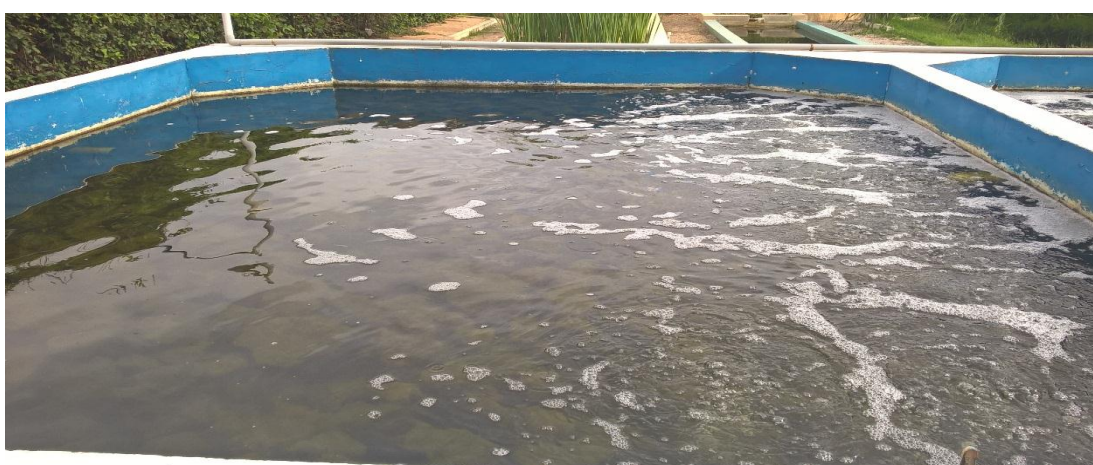
Figure 7 : Le deuxième bassin à pouzzolane
