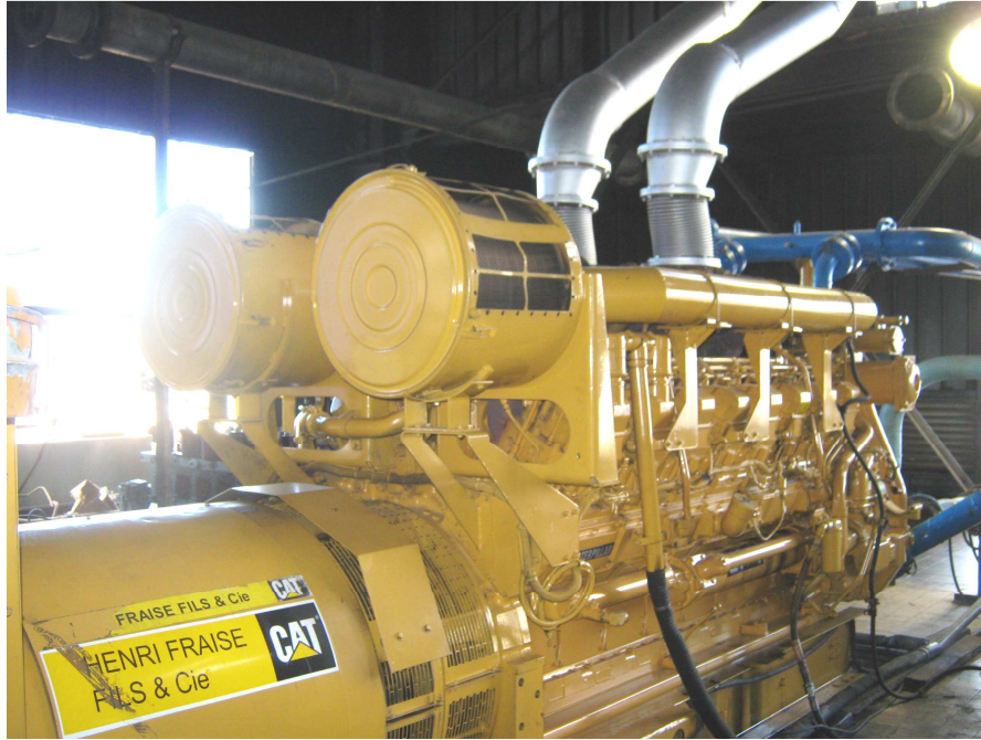
Photo N° 1 : Centrale thermique de Tuléar
