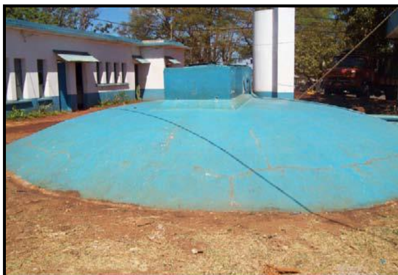
Photo 6 : Bâche de reprise de 200 m 3
