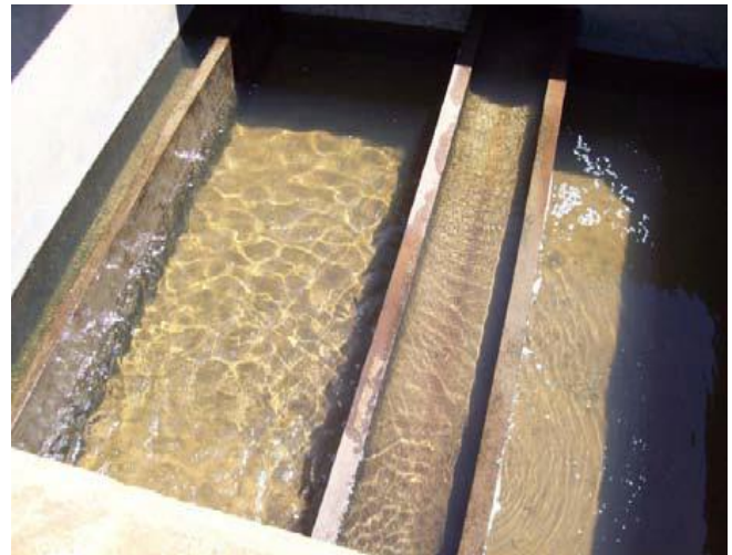
Photo 5 : Filtres à sable
