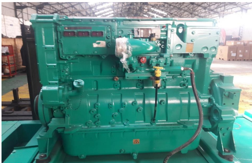
Photo 3 Moteur QSX15 groupe électrogène C550 (Puissance fournie 550KVA) DMSA
