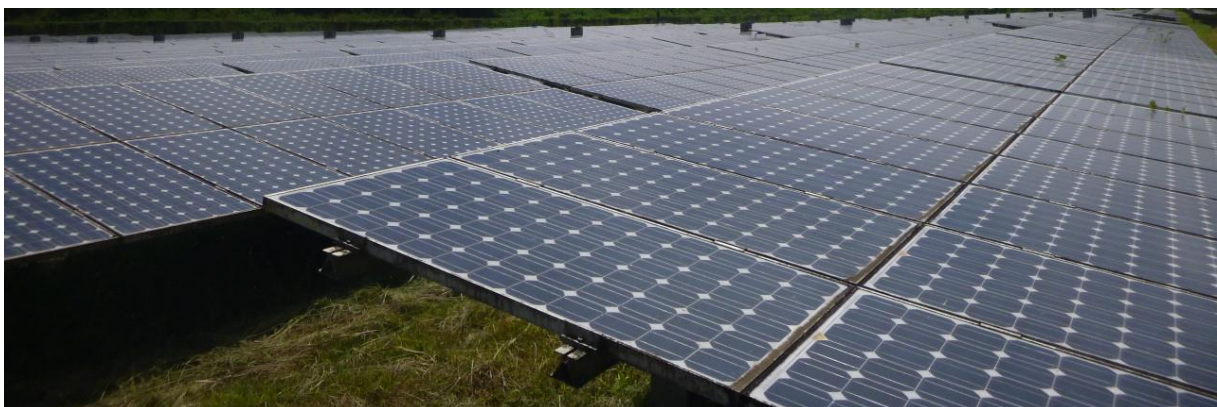
Photo 14 : Photovoltaïque au sol, sur la commune de Ducos.
