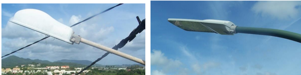
Photo 6 : Vieux luminaire (gauche) et nouveau luminaire LED (droite). Auteur : Service Technique de la commune de Rivière-Salée, n.d.
