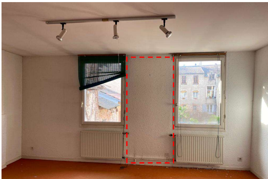
Figure 69 - Configuration initiale du R+2 et surface de paroi étudiée (en pointillée rouge).
