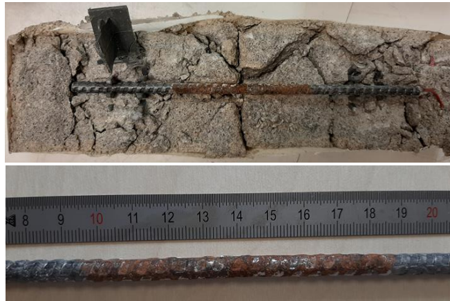
Figure 122 : Photos de l'inspection faite sur un échantillon destiné au suivi instantané de corrosion
