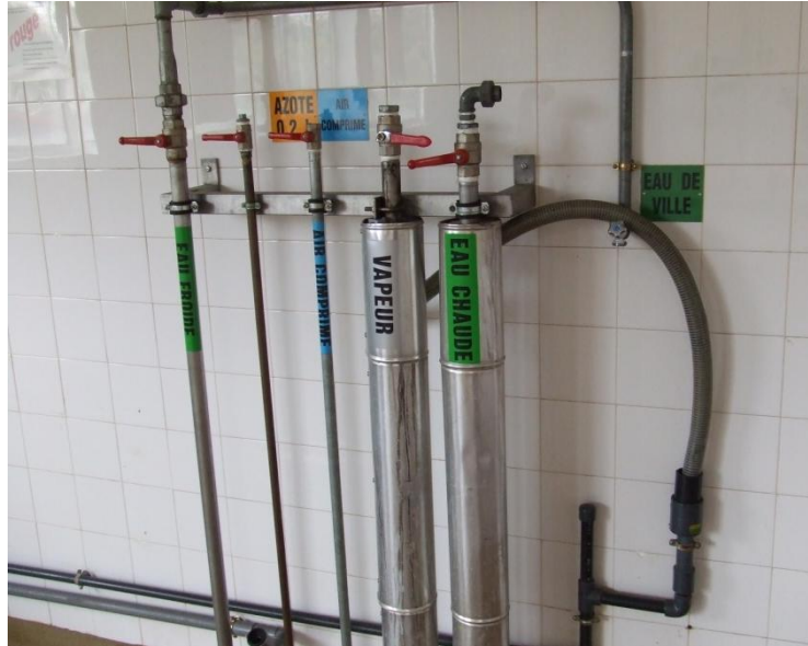
26. Robinetterie et vannes à haute pression. (Cl. P. Rosini)
