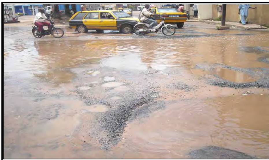
Photo 2: Exemple d'une route délabrée par les eaux de pluie à Ziguinchor
