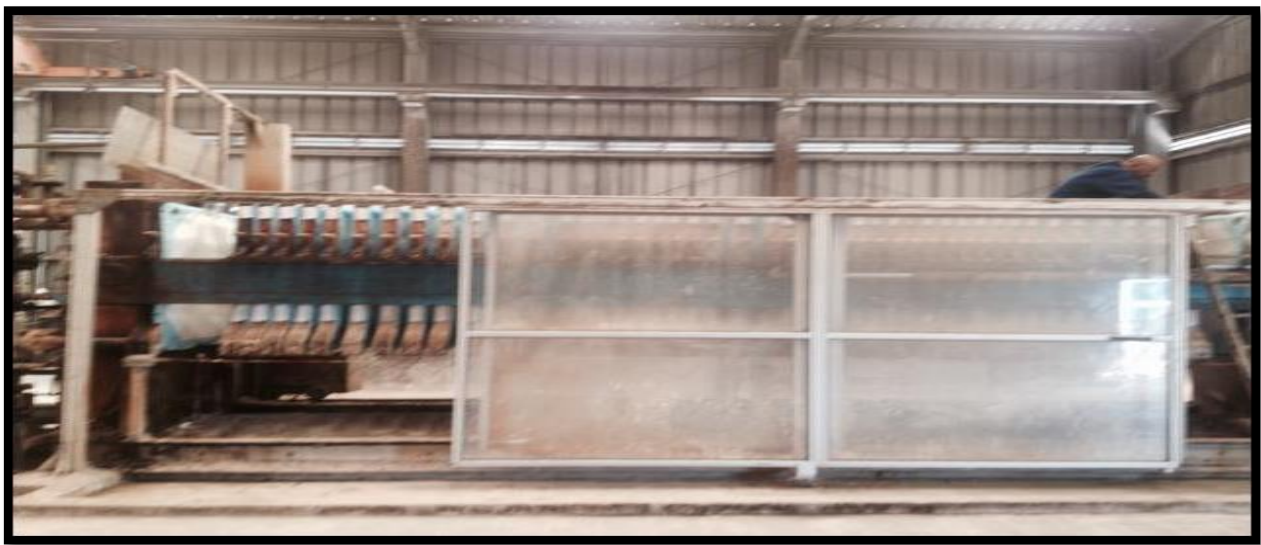
Figure 10 : La station de désucrage des boues
