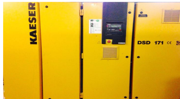
Figure 15 : Compresseur KAESER DSD 171
