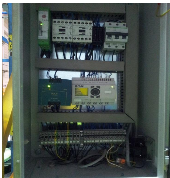
Fig57: disposition actuel de l'armoire de commande
