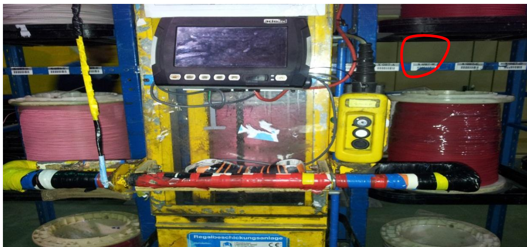
fig14: adresse emplacement bobine déchirés
