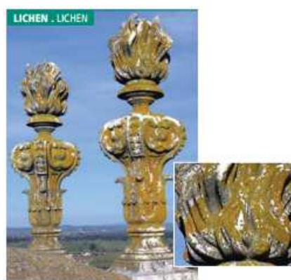
Figure I-8 : Lichens sur des pots à feu en marbre, Portugal, Évora, Cathedral, 2001. Delgado Rodrigues.
