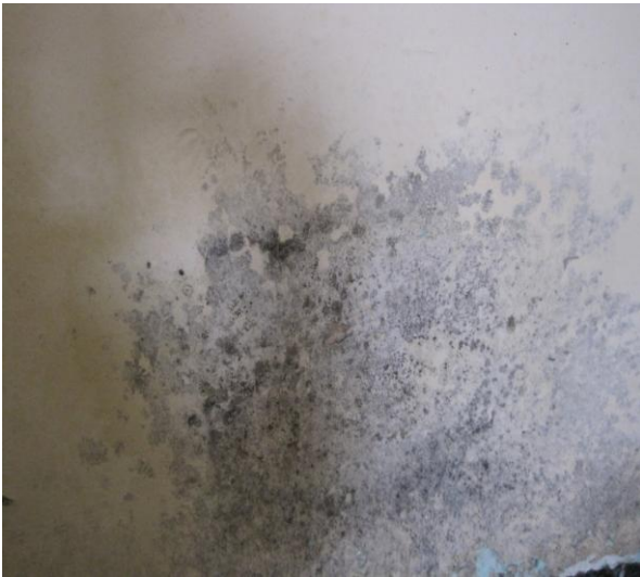
Photos 1 : Surface couverte de moisissures dans une chambre (habitat n°2)
