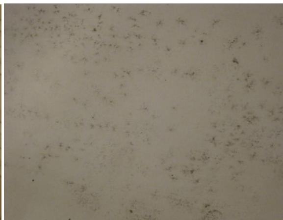
Photo 6 : Tâches de moisissures dans le salon (habitat n°2)
