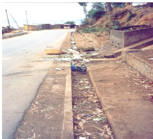
Photo 2 : Fossé envahi par des ordures (Rue Fort Voyron à Ambohijanahary)
