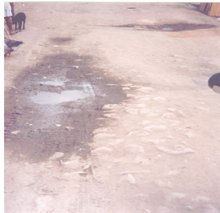
Photo 9 : Dégradation au PK 0 + 050 (Rue Anosibe – Anosipatrana)
