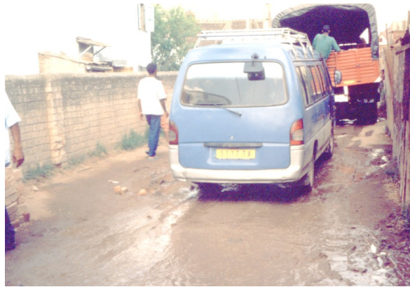
Photo 11 : Dégradation au PK 0 + 750 (Rue Anosibe – Anosipatrana)
