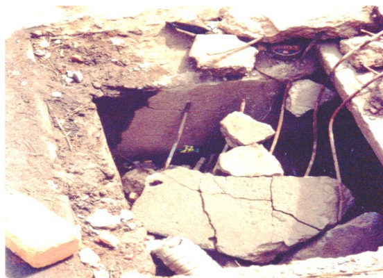
Photo 13 : Regard et fossé obstrués (Rue Anosibe – Anosipatrana)
