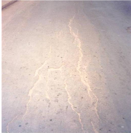
Photo 1 : Des fissures longitudinales (Rue Rabozaka à Tsimbazaza)
