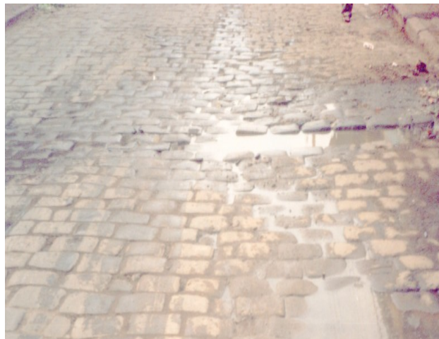
Photo 17 : Affaissement et pavés désorganisés (Rue Razanakoto à Anosipatrana)
