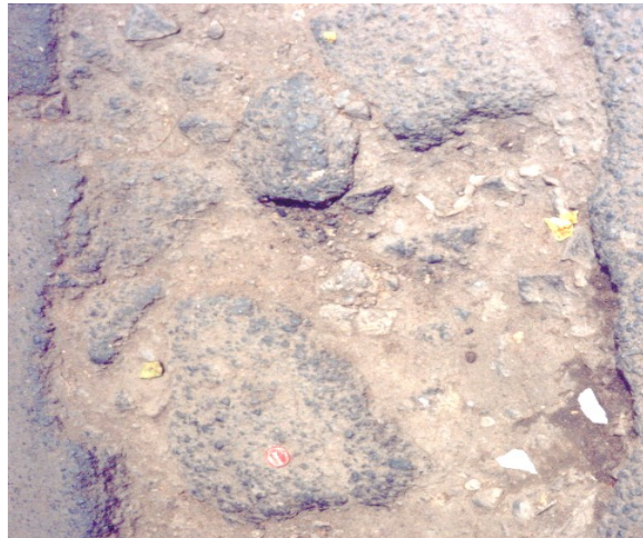
Photo 14 : Dégradation au PK 1 +150 (Rue Anosibe – Anosipatrana)
