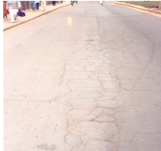
Photo 7 : Des fissures maillées (Rue Jeneralv Ratsimandrava à l'Ouest Ambohijanahary)
