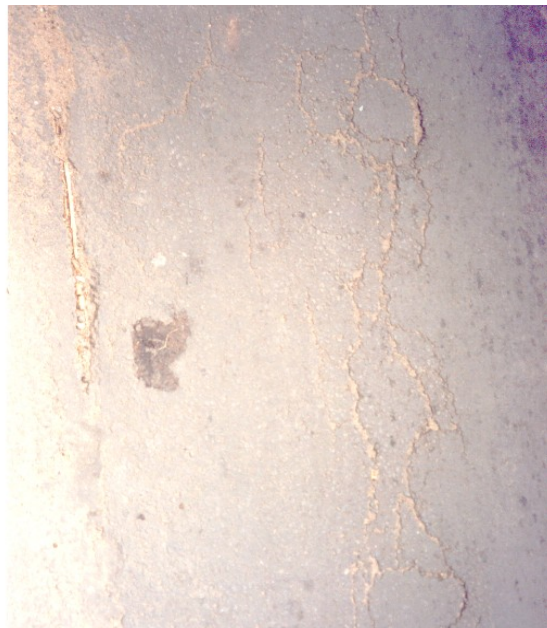
Photo 8 : Fissure longitudinale (Rue Rabotovao Samuel à Ankadimbahoaka)
