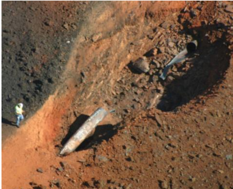
Figure III. 1 Pipe de gaz après explosion [34].
