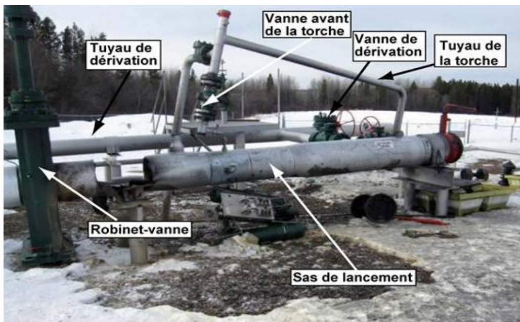
Figure III. 3 Eclatement d'un pipeline après défaut de fissure [36].
