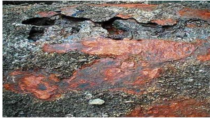
Figure III. 11 Corrosion interne (corrosion Bactérienne) [98].
