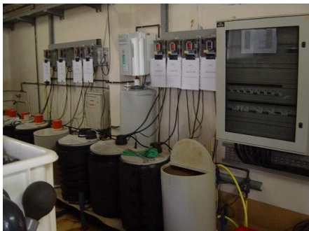
Figure 2.11 – Cuves de vieillissement.
