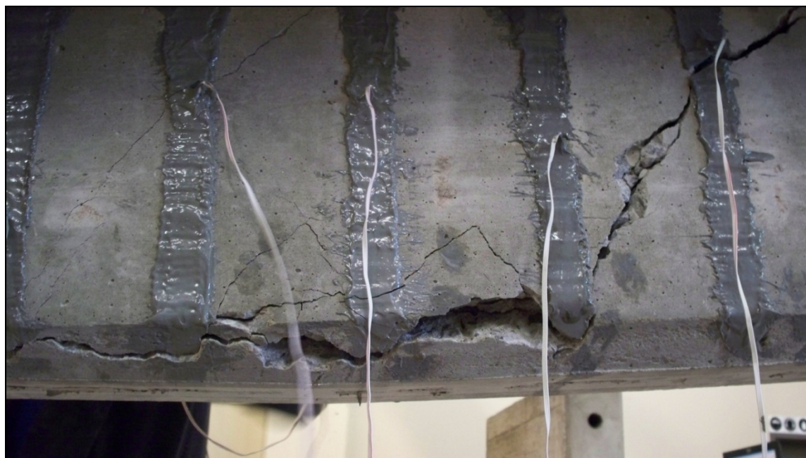
Figure 11.1 Propagation des fissures par derrière les barres de renfort NSM.
