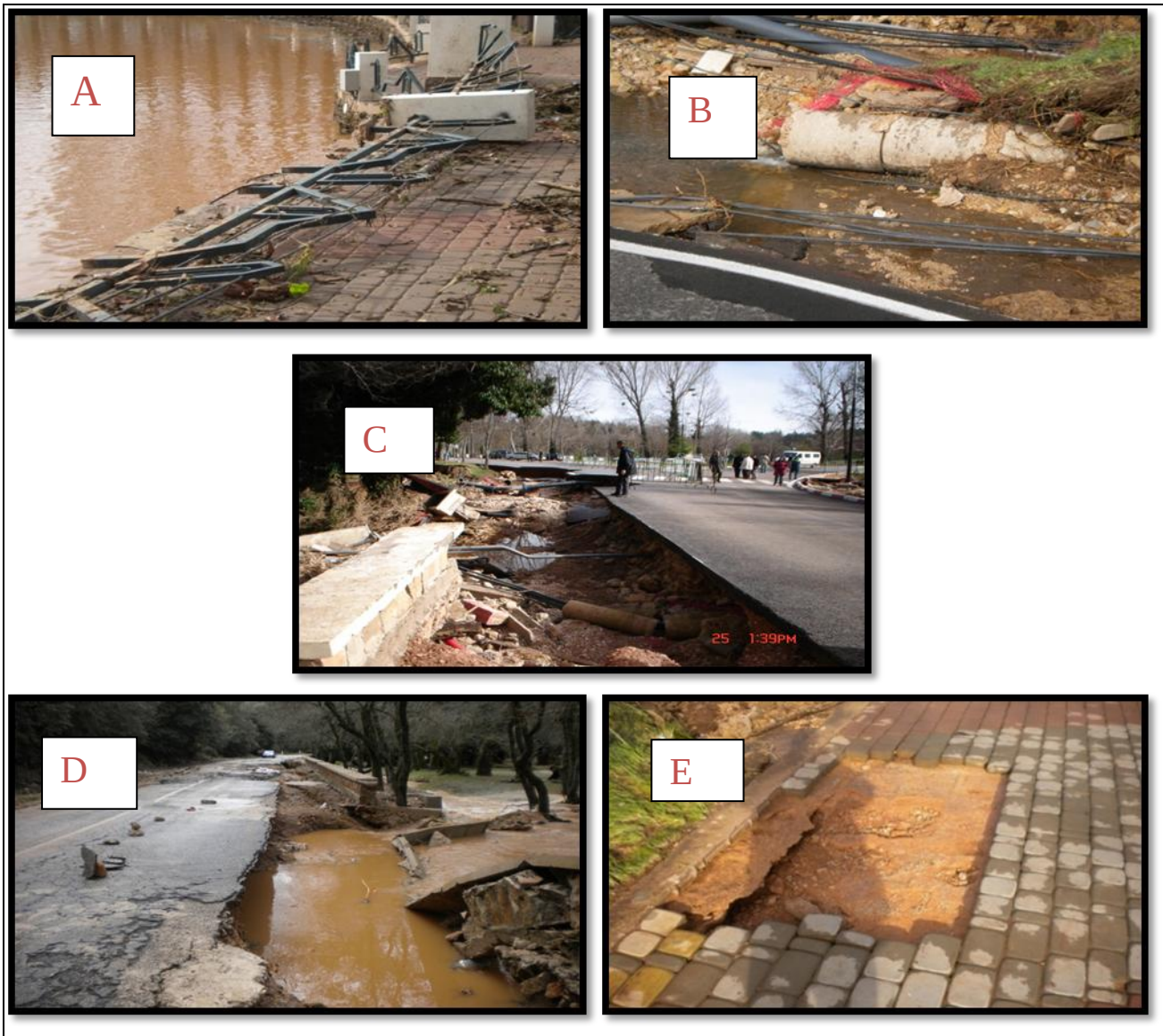
Photo 1: illustration des dégâts sur les infrastructures
