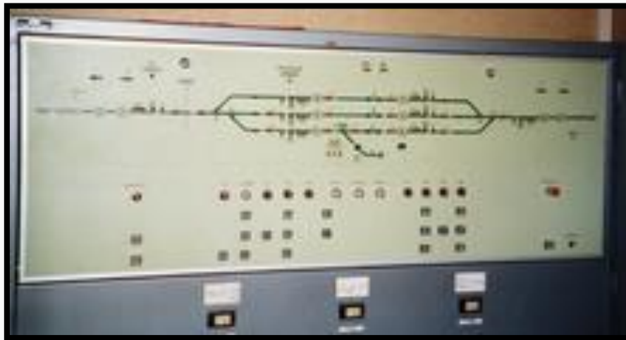
Figure 17 : Tableau de Commande et de Contrôle (TCC)
