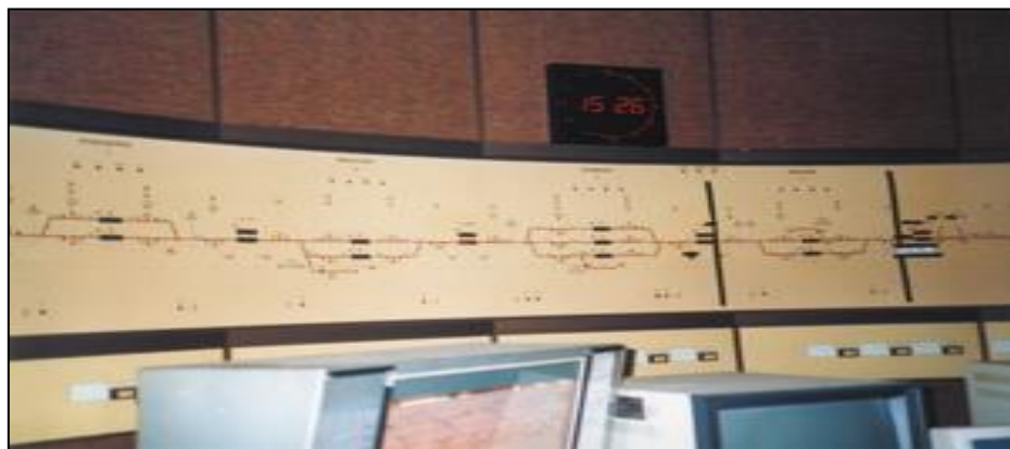
Figure 20 : Salle de contrôle PRS
