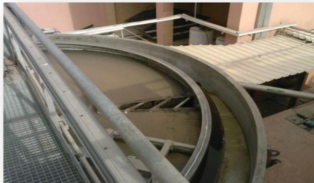
Figure 7 : Bassin de clarifloculation
