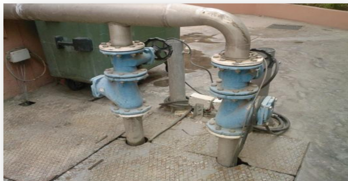
Figure 3 : L'entrée du dégrilleur
