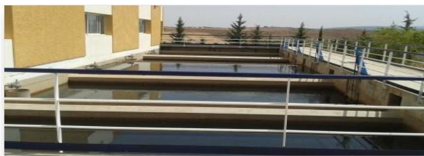
Figure 6 : image du bassin de filtration
