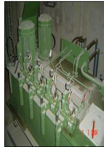
Figure 18: Centrale hydraulique pompe pour vérins fixes et pour vérins de travail
