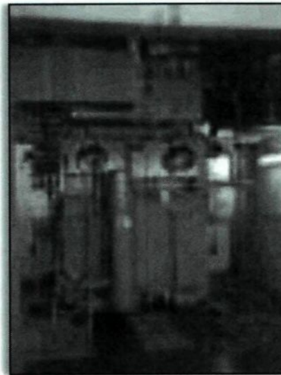
Figure 18: Transformateur à isolation semi-hybride (5 MVA) pour l'alimentation de circuits d'excitation dans une centrale nucléaire [35].
