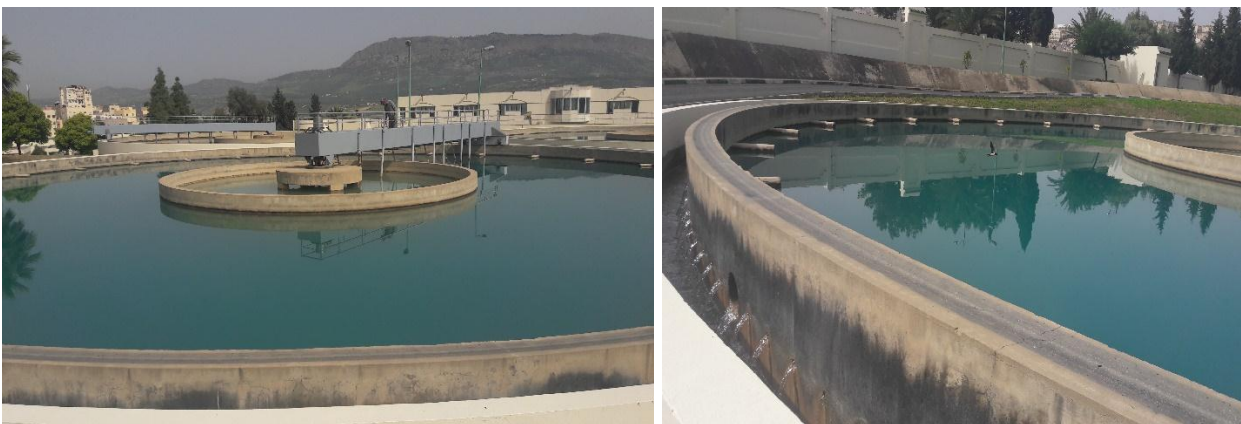
Figure 3 : Décanteurs a , b
