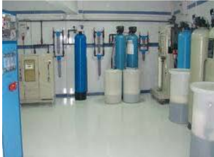
Figure n° 7 : Station de traitement d'eau pour hémodialyse
