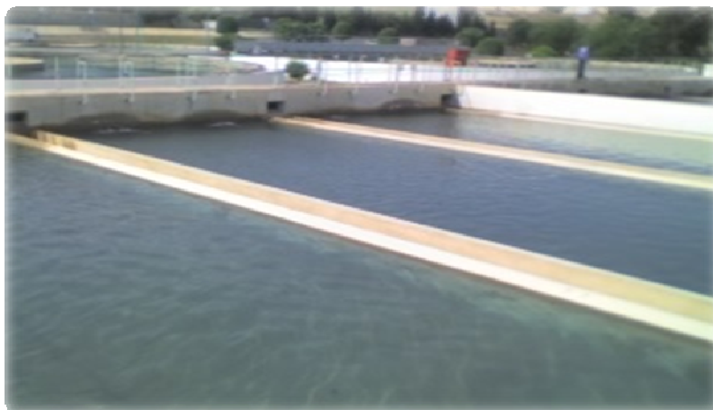
Figure 5 : Filtres à sable
