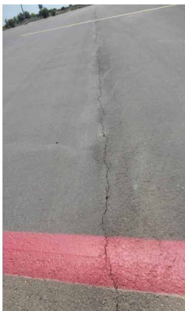
Figure 4.1 Dégradation de la piste de l'aéroport Messali El Hadj Tlemcen : Photo1
