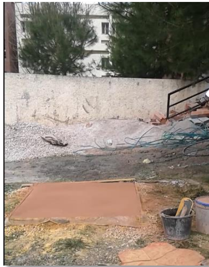
Figure 1. 7. Saupoudrage du produit de démoulage en surface (photos prises par les auteurs)
