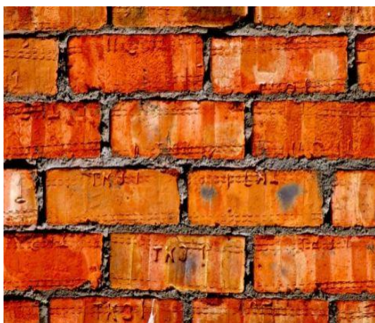
(a)- effritement de joint.
