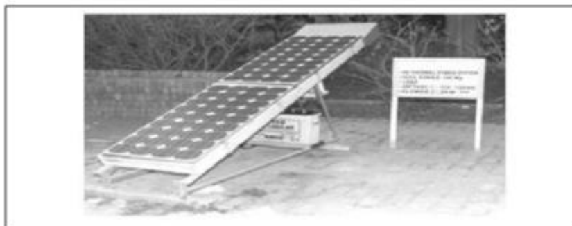
Fig.I 2: Banc d'essai du capteur solaire PV/TH hybride à air
