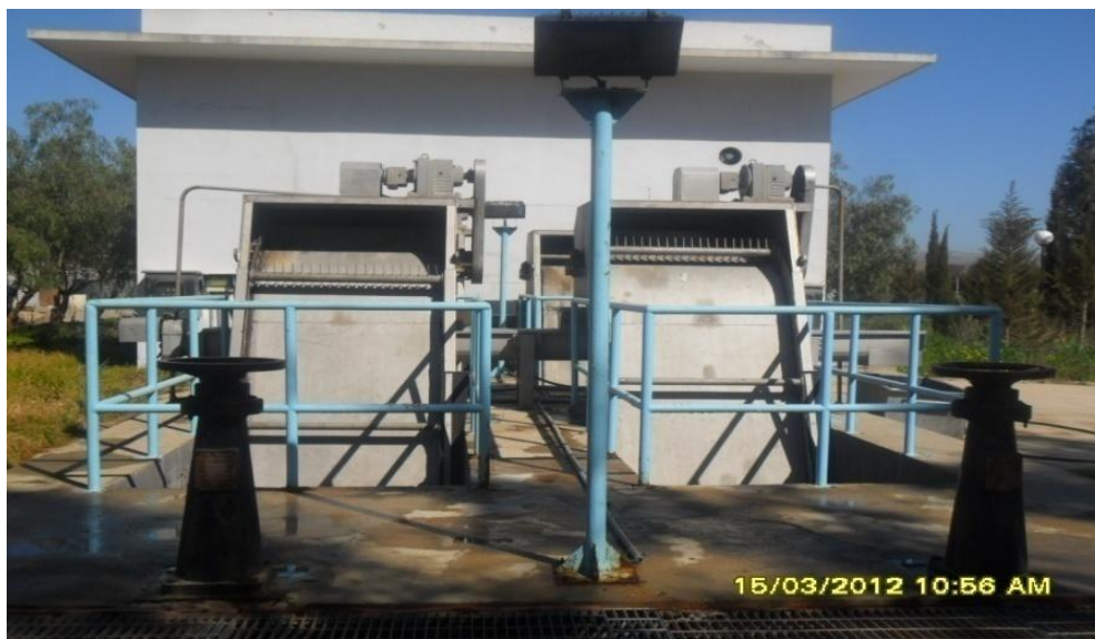
Figure IV.4: Photo d'une grille mécanisée (ONA.2012).
