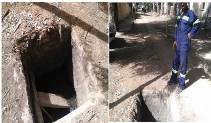
Figure III.8 : Réseau d'assainissement colmaté dans Hai Saf Saf.
