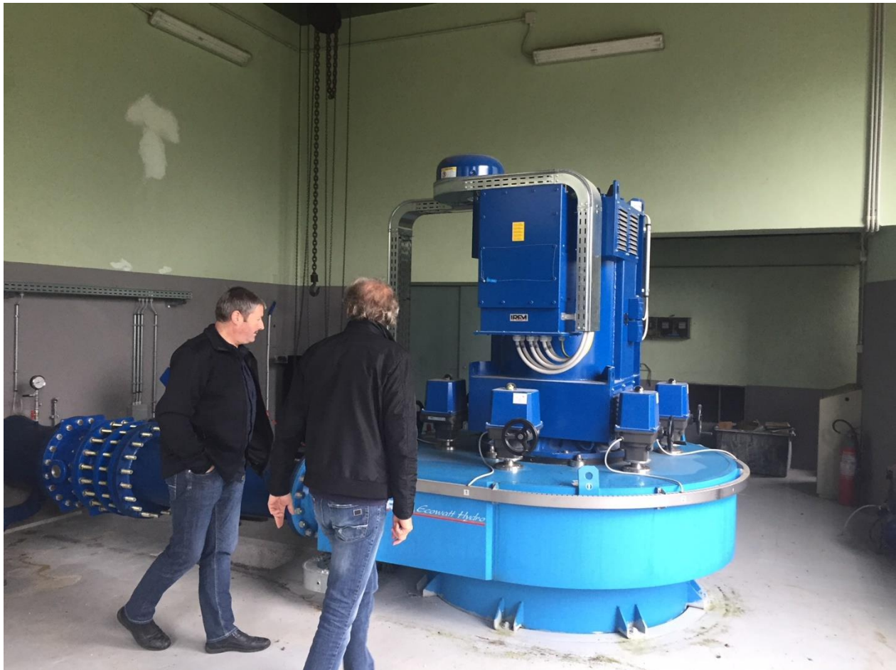
Photo 10 : Exemple d'encombrement d'une turbine de 300 kW fournie par la société IREM
