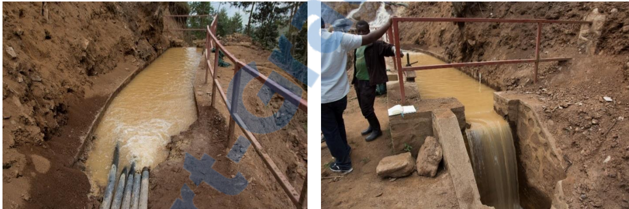
Photo 5 : Dessableur et déversoir du canal d'irrigation
