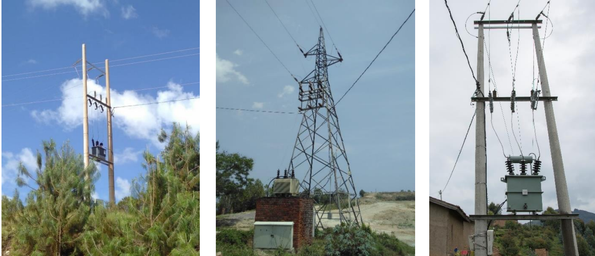
Photo 11 : Exemples de distributions MT - BT au Rwanda
