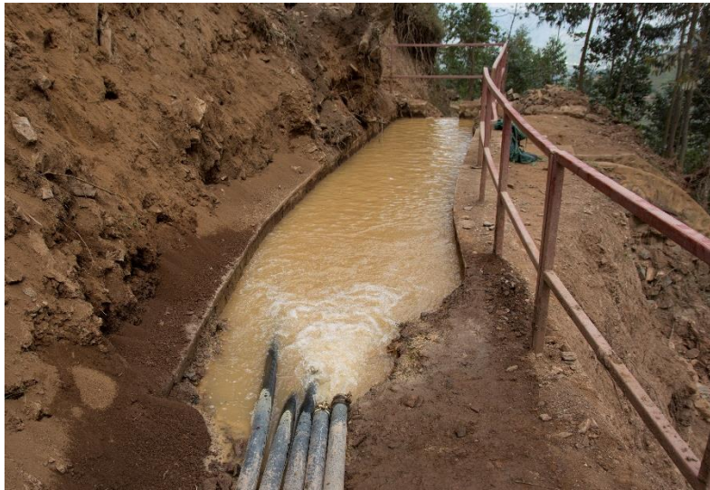
Photo 8 : Reste du dessableur alimentant le canal d'irrigation
