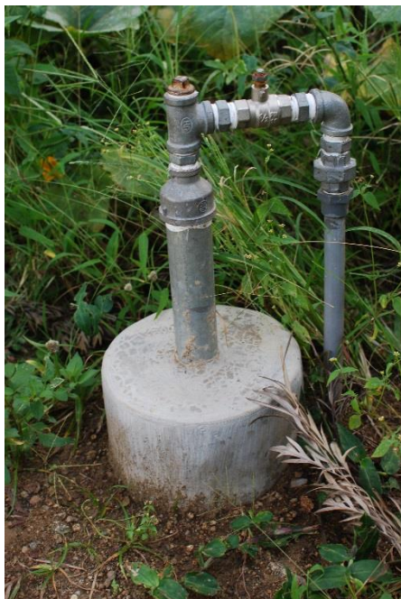
Fig. 17: robinet de gaz présent au sommet du dôme de la chambre de digestion. Les deux écrous permettent la fermeture de la sortie de gaz, soit avec une clé à tube (gauche) soit avec un robinet amovible (droite). Photo prise le 4 juin 2018 sur la propriété d'Éric NYANDWI.
