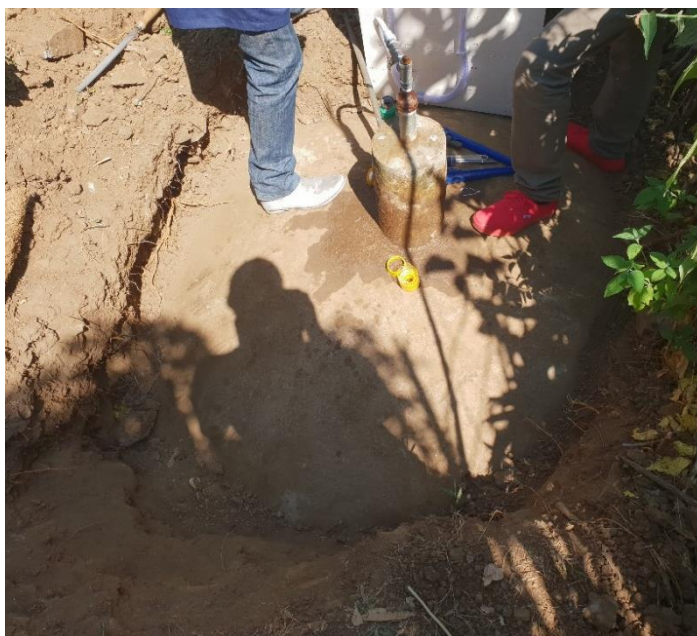
Fig. 18: contrôle de l'intégrité du dôme de la chambre de digestion au moyen d'eau savonneuse. L'absence de bulle permet d'attester du bon état général du dôme. Photo prise le 11 juillet 2018 sur la propriété de S. NTAGAHINDA.
