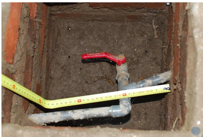
Fig. 16: robinet de purge permettant l'évacuation de l'humidité dans les canalisations de gaz, située après le robinet du biogaz (conduite en bas à droite), au sommet du dôme. Photo prise le 04.06 sur la propriété de Simon NTAGAHINDA.
