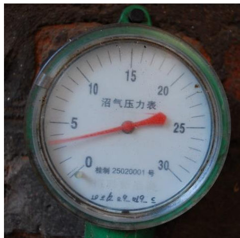
Fig. 9: manomètre utilisé dans les services correctionnels rwandais (RCS) sur les installations de méthanisation. Photo prise le 12.06 à la prison de RUBAVU.
