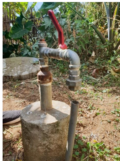
Fig. 13: robinet du biogaz, situé au sommet du dôme (enterré) et début de la canalisation permettant l'acheminement du gaz vers la cuisine. Photo prise le 28.06 sur la propriété de Simon NTAGAHINDA.
