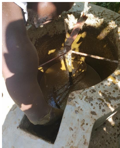
Fig. 7 : chambre d'alimentation couplée au digesteur et munie d'un bouchon permettant d'homogénéiser le substrat avant son injection dans la chambre de digestion. Photo prise le 29.06 dans la propriété de Simon NTAGAHINDA.
