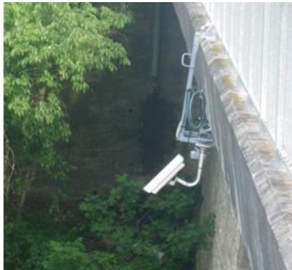
Figure 18: Support pour le radar et la caméra à Vogüé gare
