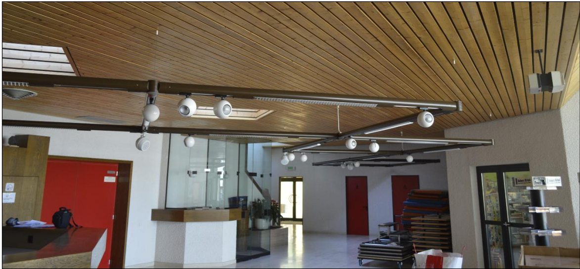
Figure 20- Luminaire hall d'entrée
