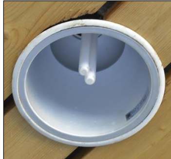
Figure 15- Luminaire pavillon d'entrée
