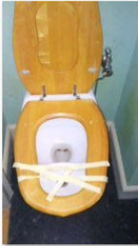
Figure 4.14 : Toilette à séparation d'urine bouchée au niveau du tuyau d'évacuation des urines.
