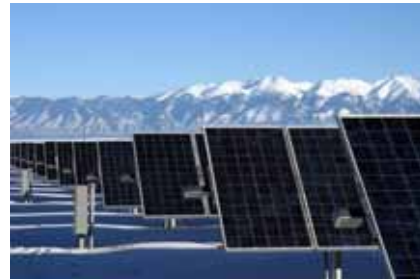
Un seul axe, ajustement saisonnier manuel Sun Edison PV power plant (Alamosa, Colorado) Source : NREL
