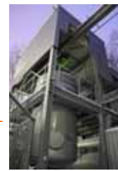
Stockage matériaux solides 50 à 620°C
