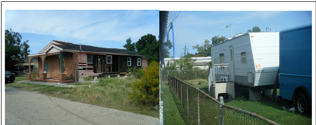
Figure 2 : Une maison endommagée par Katrina. 2-2 : Une caravane transformé en maison avec escalier
