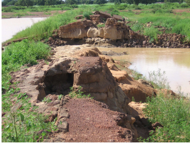
Tanghin : Rupture du barrage
