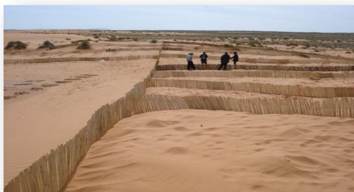
Photo 7 : Fixation mécanique Zone de Gaaloul – Ain Ben Khelil
