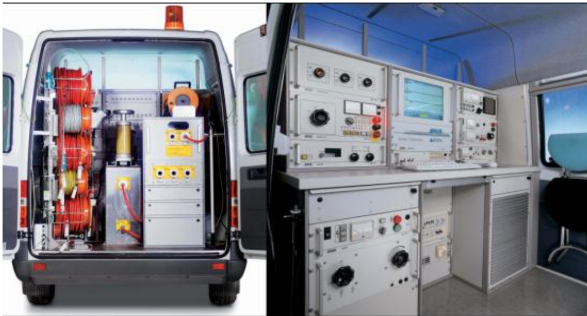
Figure 22 : Camion de diagnostic (2)
