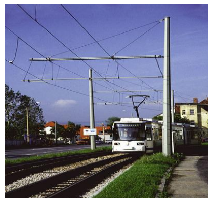
Figure 2.4 Poteau pour LAC tramway
