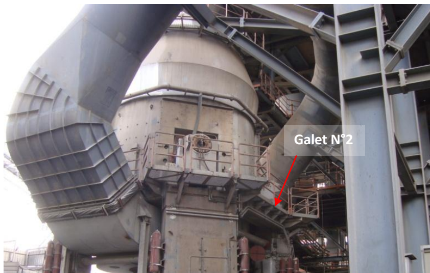
Figure 2-12 : Position du galet N° 2 dans le bâtiment broyeur
